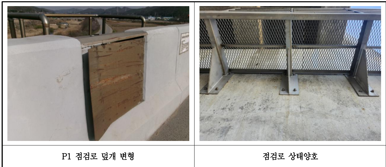
【사진 1.3.26】교량 점검시설 손상현황
