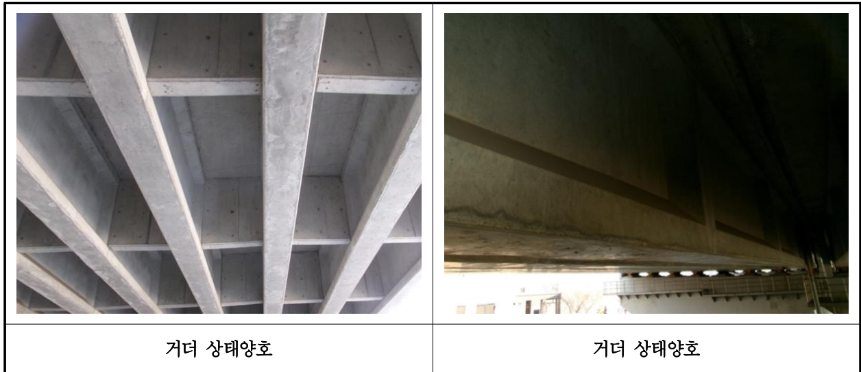
【사진 1.3.5】 거더 손상현황
