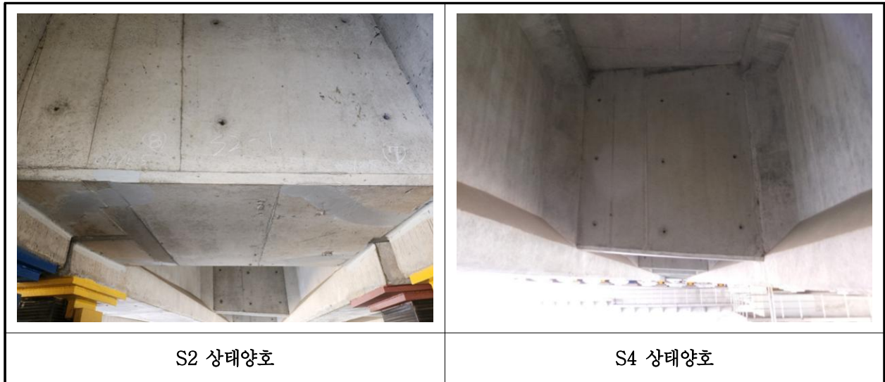
【사진 1.3.7】 가로보 손상현황
