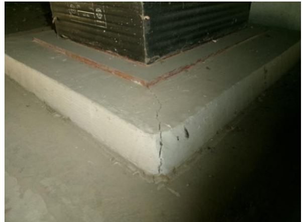
A1-SH5 받침몰탈 균열(0.1mm/0.1m)
