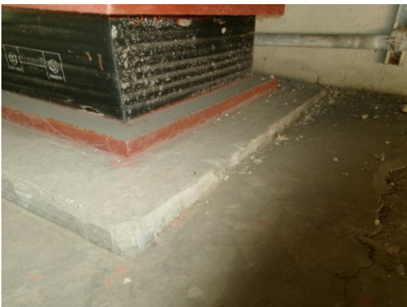
A1-SH7 받침몰탈 파손(0.1m×0.1m)
