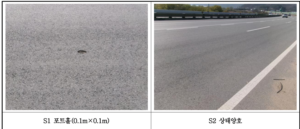
【사진 1.3.20】 교면포장 손상현황
